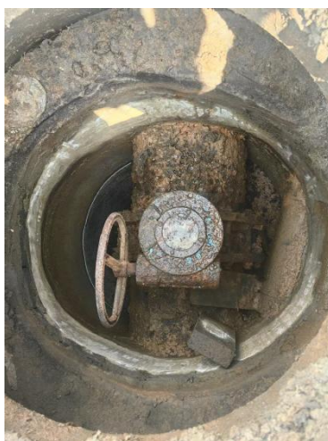
雨水总排口阀门 (阀柄与管线水平方向为关闭)
