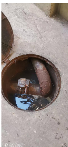
雨水总排口阀门 (阀柄与管线水平方向为关闭)
