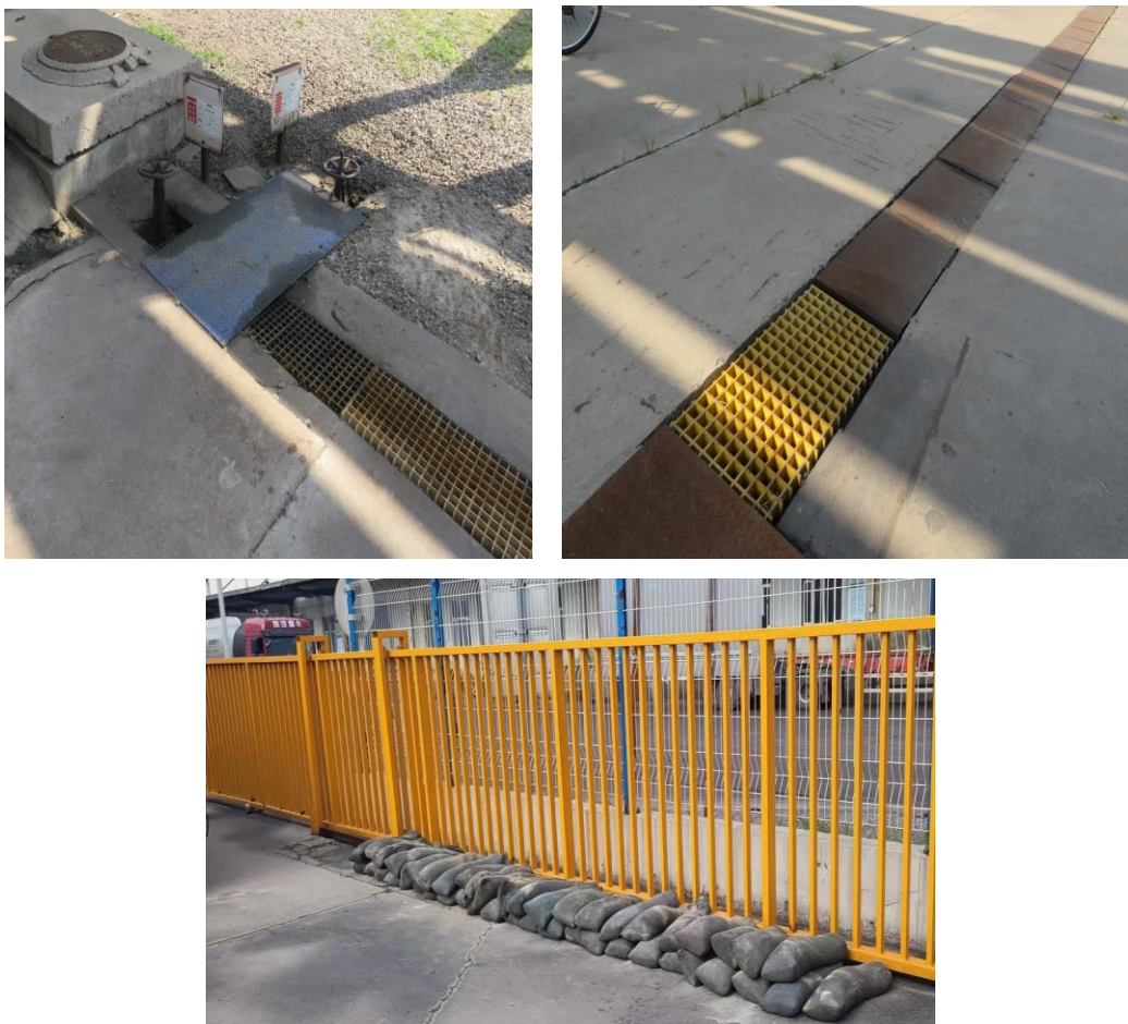
图 5-2 成品装车台区域明沟和槽车出入口围堵物资
