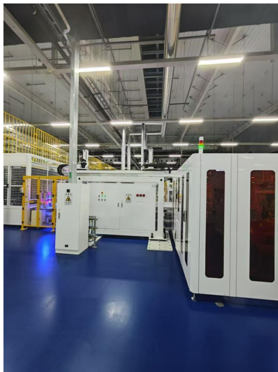
ACF 上方收集管道
