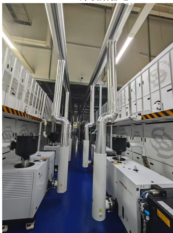
层压区集气管线
