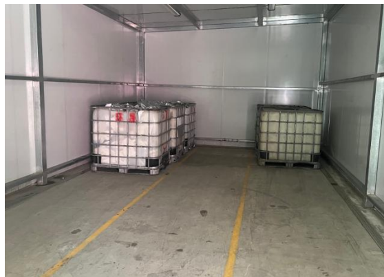
危险废物暂存间内部 2
