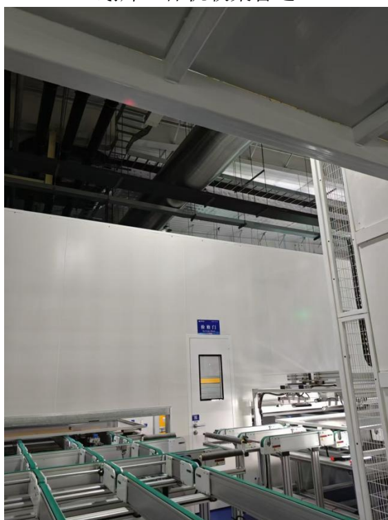
封闭固化室及上方集气管线
