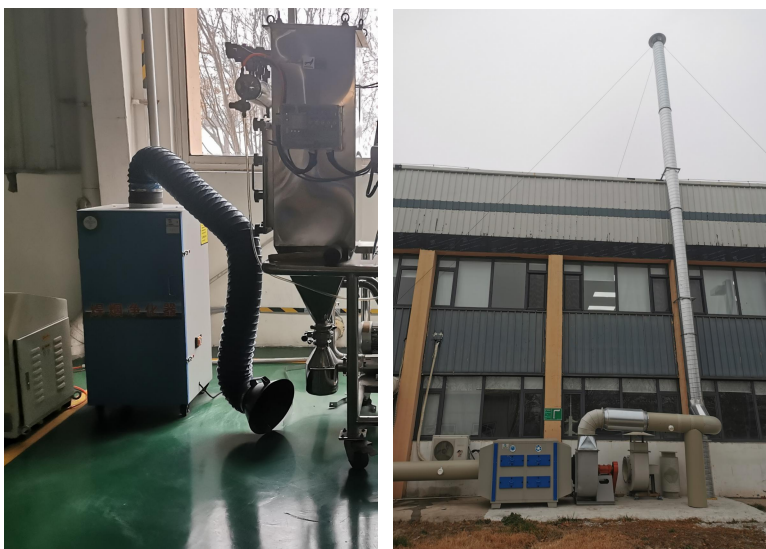
图 3-1 厂区废气处理设备集气罩、活性炭吸附设置和排气筒
