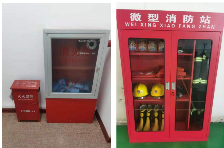
图 3-7 干粉灭火器、室内微型消防站
