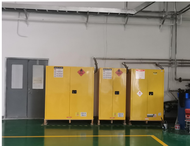
图 3-6 药品、试剂存放柜
